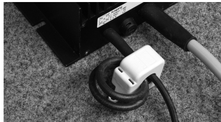
Abb. 2: Am Sekundärkabel des Gerätes montierter Ferrit
